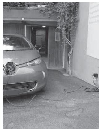
Ladestation für E-Autos
